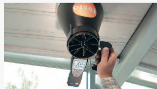
Kontrolle der Zuluft an einem Tellerventil
